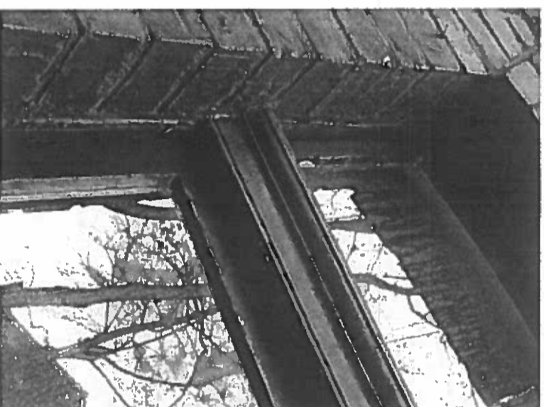
Fot. 2: Stolarka okienna, typ O-02, detale: belka ślimienna. Źródło: Fotografia. Autorzy opracowania (OUTIN Architektura).
